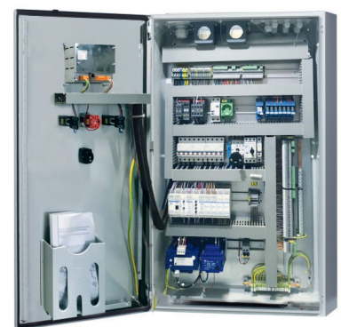
Steuer- und Regelanlage
